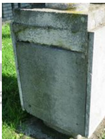
Detail poškození soklu (06/2026/JJ)
